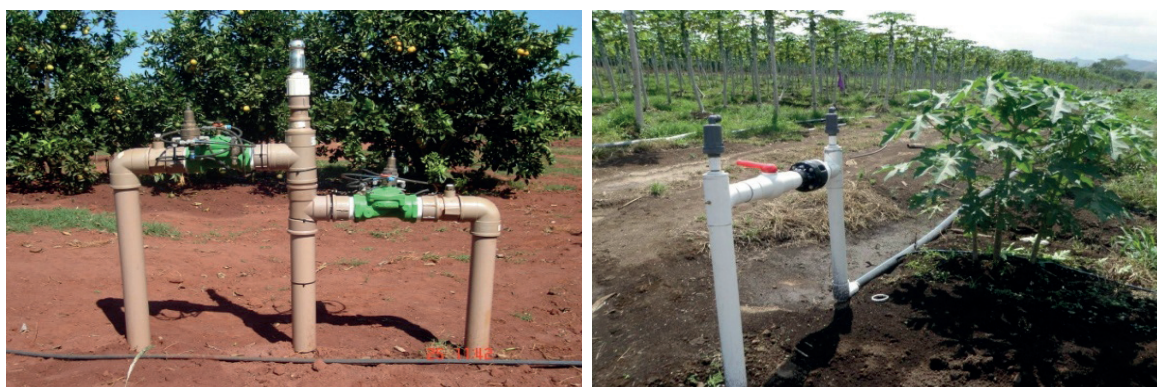
Figura 5. Vista dos cavaletes de unidades de irrigação. (Fonte: Frizzone et al. (2012))
